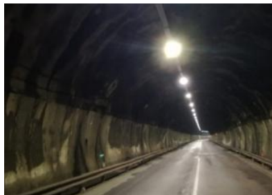
Già accesi i nuovi fari all'interno dei tre tunnel del Passo del Cavallo
