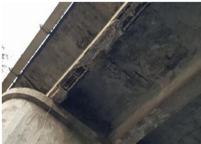
I ferri dell'armatura in vista sotto il ponte di ingresso a Idro
