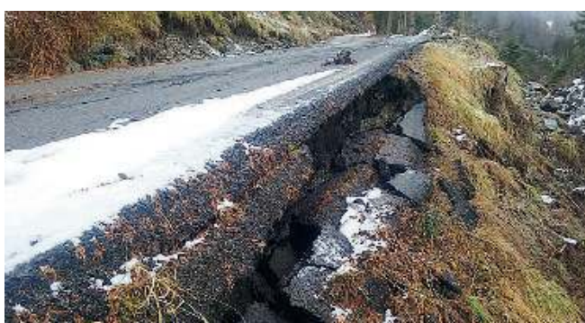
Cedimento. Il bordo della carreggiata danneggiato dal maltempo
