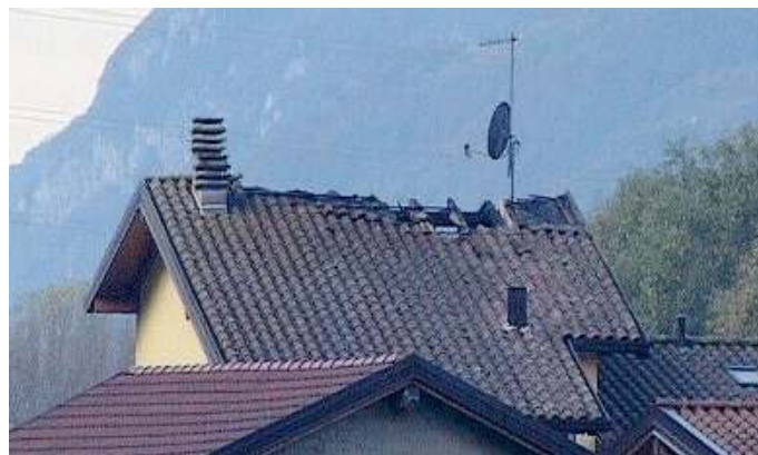
Distrutto. I danni causati dal rogo al tetto dell'abitazione
